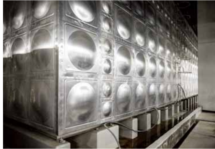
테크노돔 본관은 대체 에너지원 가운데 효율이 가장 좋은 지열을, The Residence(기숙사동)는 태양전지를 사용해 일정 수준의 에너지를 자체 충당한다. 화석연료를 사용하는 전기에 대한 의존도를 줄인다는 의미다. 본관의 축열 탱크.
